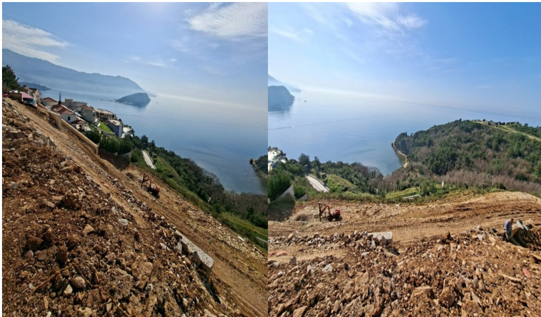
Sl. 6 i 7. Prikaz stanja na terenu sa lokacije Komoševina
